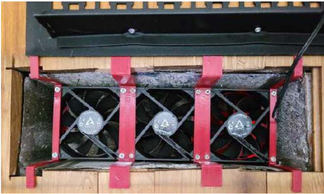
Fotografia 1. Wentylatory zainstalowane w kanale wentylacyjnym przy jego wyjściu
