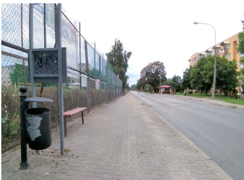
Ul. Orzechowa ma spękaną i nierówną nawierzchnię, sypiące się krawężniki, studzienki kanalizacyjne nieodbierające wody. Szpecą zaniedbane i prowizoryczne przystanki (część bez zadaszeń)
