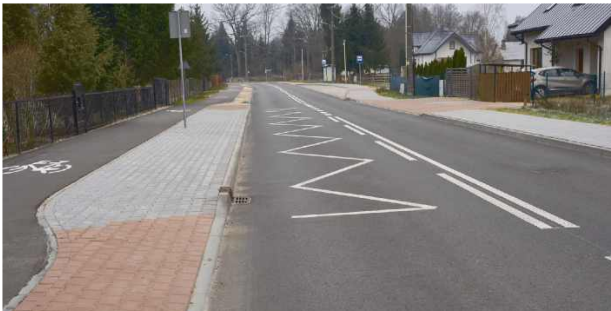
Rozbudowa drogi powiatowej nr 3635W to jedna z największych inwestycji ostatnich lat w Powiecie Siedleckim.
