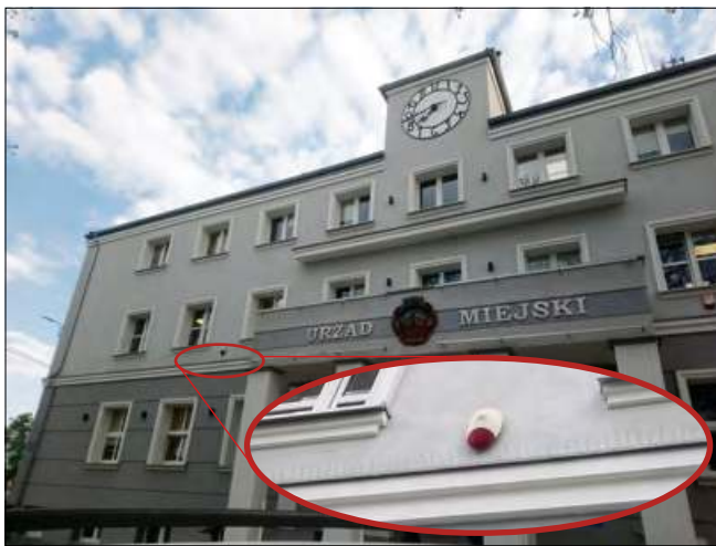
Po remoncie elewacji na urzędzie zamontowano ostre druty, na które ptaki mogą się nabić.
