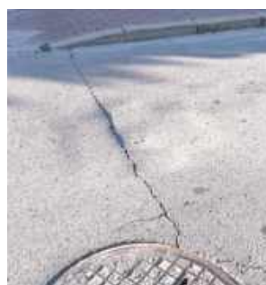
Stan drogi jest szczególnie odczuwalny przy wjazdach na posesje. Jeden z mieszkańców obawia się, że nawierzchnia w tym miejscu może się dodatkowo załamać...
