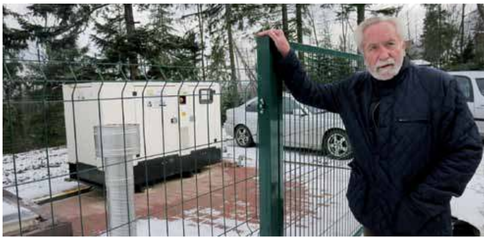
Janusz Bazydło pyta, po co agregat, skoro ciśnienie wody po sezonie, gdy na Bogdańskiego apartamenty stoja puste - jest wystarczające?
