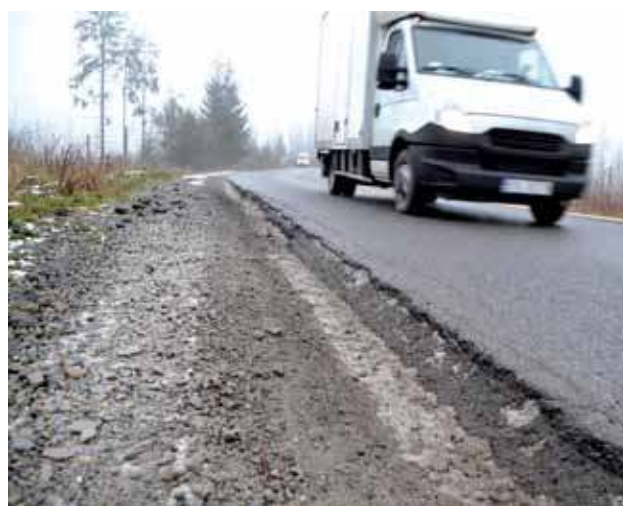
W wielu miejscach pobocza wymywa woda.
