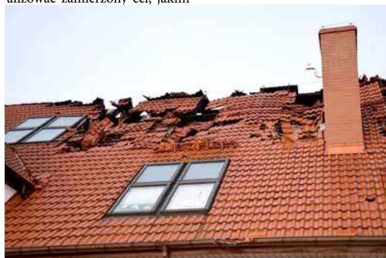
Pożar, który wybuchł w budynku szkoły strawił część dachu wraz z poddaszem
