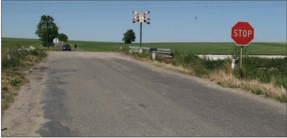
✚ Kierowcy korzystający z tej drogi od wielu lat czekają na poprawę jej nawierzchni. Według planów droga ma być zmodernizowana do 10 czerwca 2020 roku
