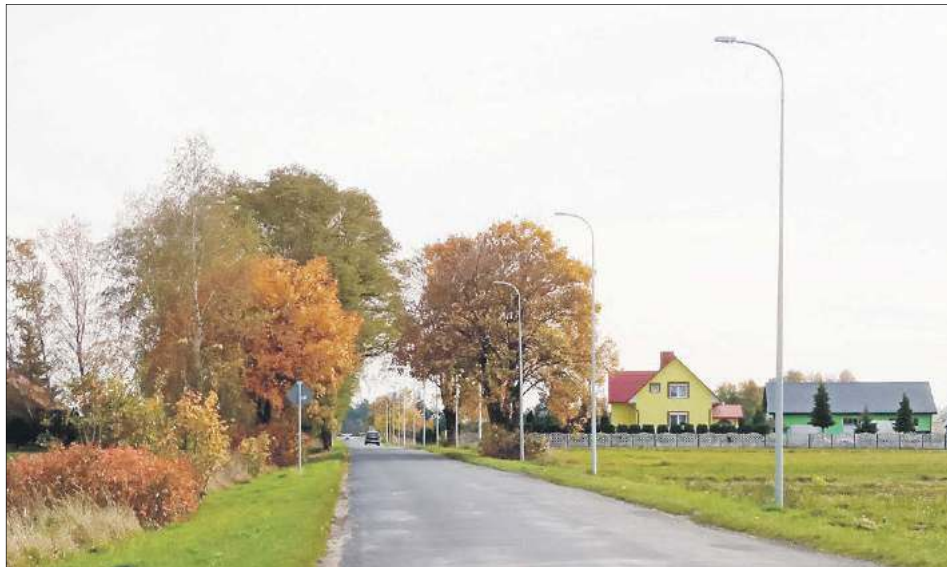
Nowe punkty oświetlenia ulicznego w miejscowości Rogoźnica
