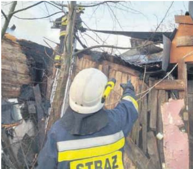
W akcji trwającej blisko 5 godzin brało udział 7 zastępów straży pożarnej. Fot. st. kpt. Marcin Lebedowicz/KP PSP Hrubieszów
