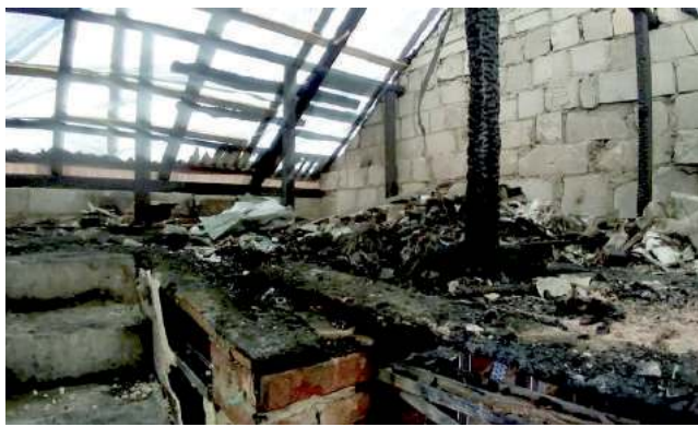
Poddasze uległo w całości zniszczeniu. Spaliła się więźba dachowa i poszycie dachu oraz materiały zgromadzone na poddaszu
