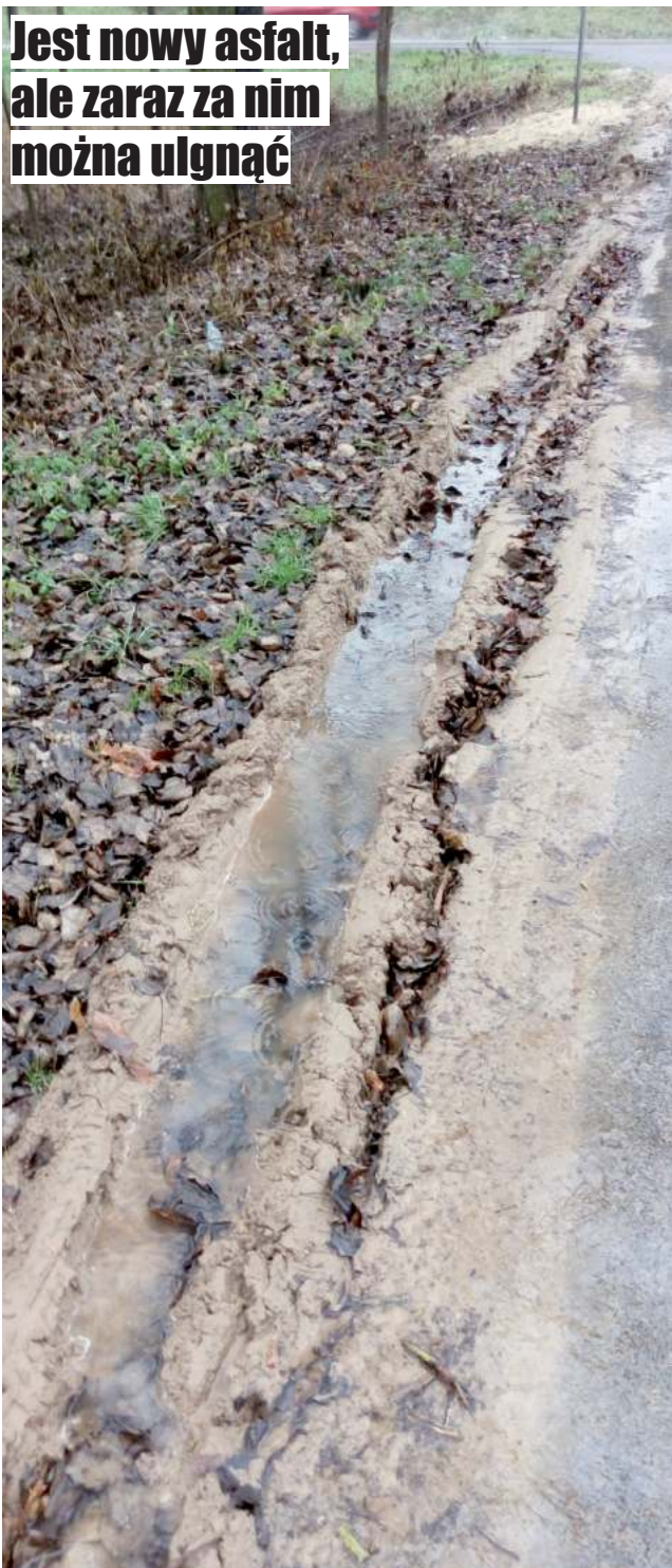
Samochody kierowców, którzy w drodze do Mareczek zjadą z asfaltu mogą ulgnąć w błocie
