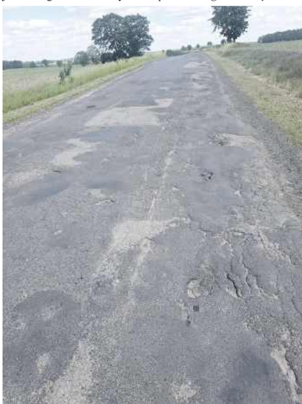
Aktualny stan nawierzchni na drodze powiatowej Przeworno - Karnków
