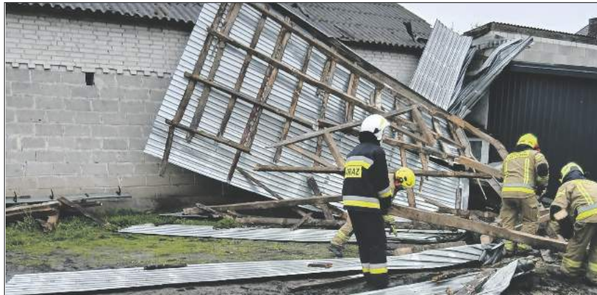
W Kraskach Górnych po godz. 7:00 wiatr zerwał dach z budynku gospodarczego
