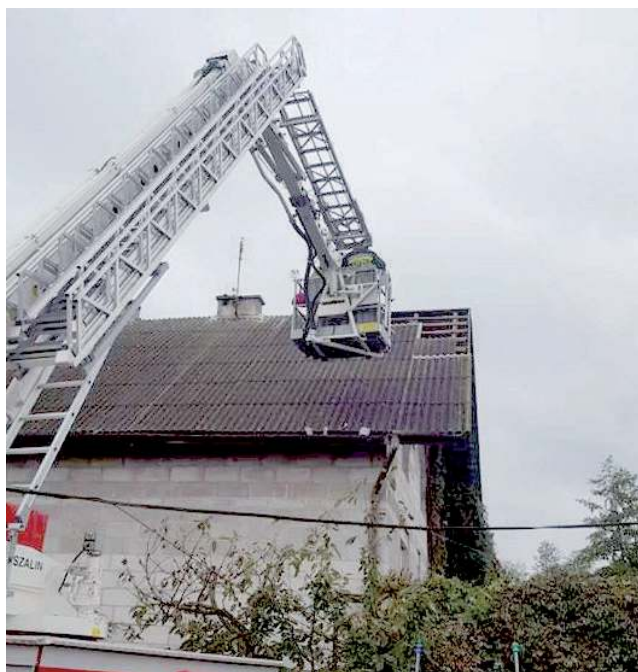
W Pusznie wichura naderwała dach na budynku mieszkalnym. Strażacy przykryli budynek zapasowym eternitem
