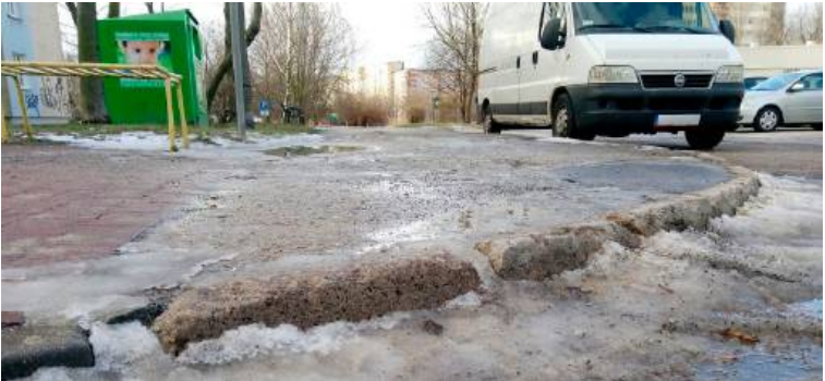
Zwłaszcza dla osób niepełnosprawnych i z wózkami dziecięcymi chodniki na os. Karłowicza pozostaną prawdziwym torem przeszkód
