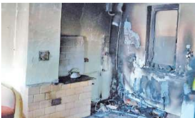
Budynek mieszkalny po eksplozji ma wąskie pęknięcia na ścianach, ale nadaje się do dalszego zamieszkiwania.
