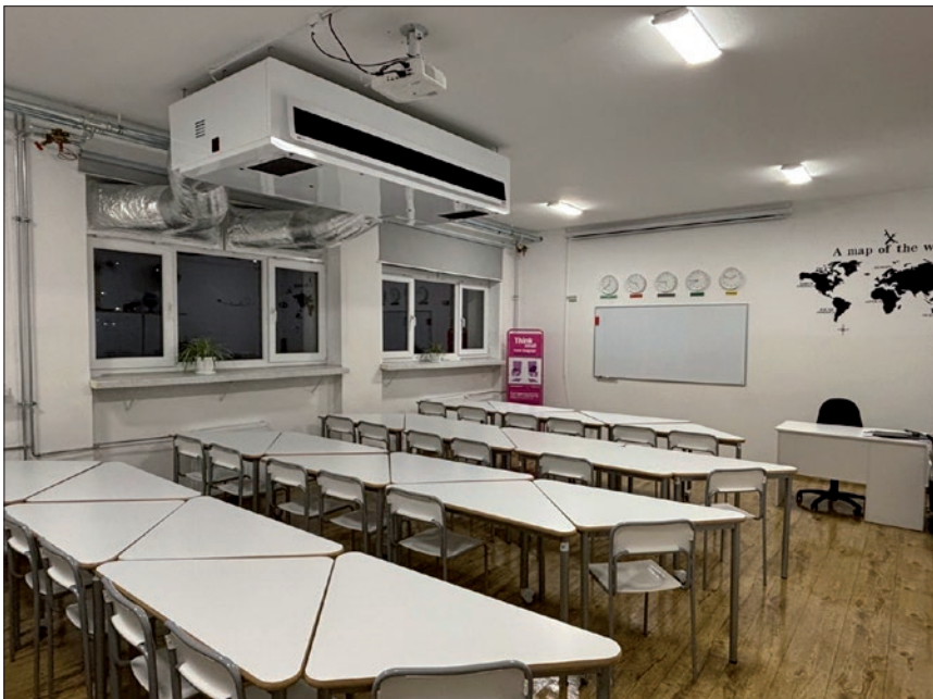
Fot. 1. Widok klasy z podsufitową centralą wentylacyjną 2VV
