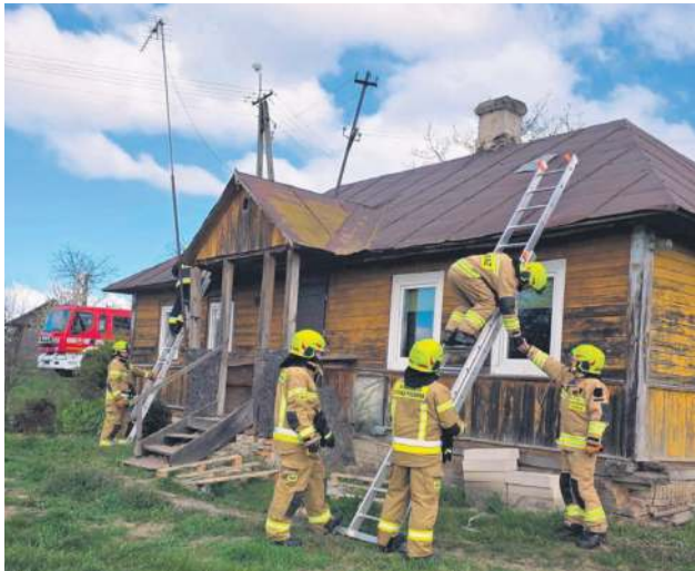
Porywisty wiatr uszkodził dachy na pięciu domach w Hrubieszowie, Dziekanowie (gmina Hrubieszów), Oszczowie i Chochłowie (gmina Dołhobyczów) oraz w Smoligowie (gmina Mirce).
