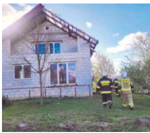
Strażacy 8 razy interweniowali przy uszkodzonych dachach.
