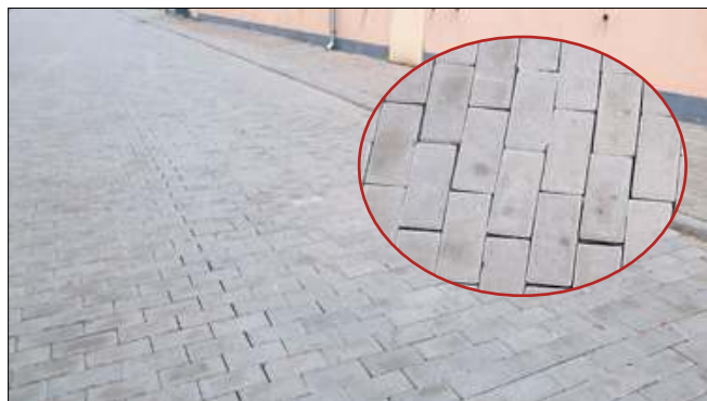
Po ostatnich poprawkach pomiędzy kostką powstały duże luzy.
