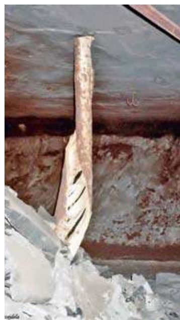
Stojak pękający pod naporem stropu
