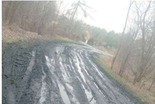
!„Ta droga się rozpyla. To w chwili obecnej najgorzej utrzymana droga w Annoborze” - piszą mieszkańcy. Zdjęcie dołączyli do petycji w sprawie utwardzenia drogi gminnej Annobór - Łucka
