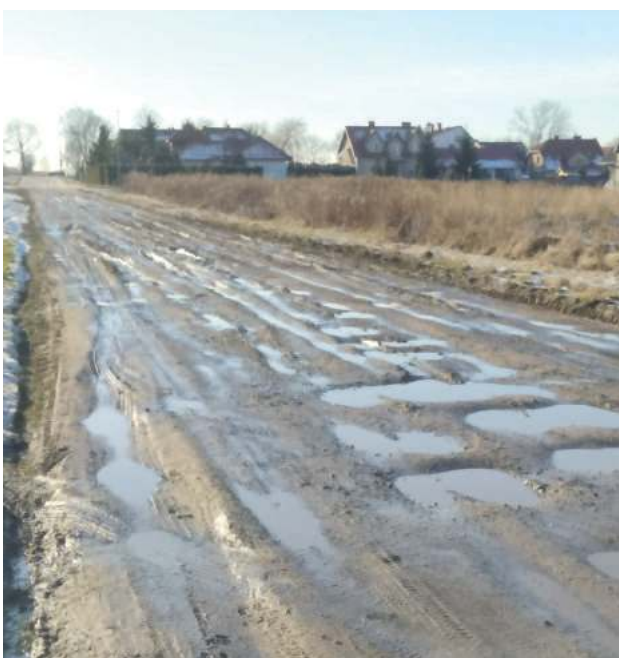
Droga podziurawiona jak ser szwajcarski. Mieszkańcy Łucki podkreślają, że droga jest w fatalnym stanie. Pytają, kiedy będzie remont
