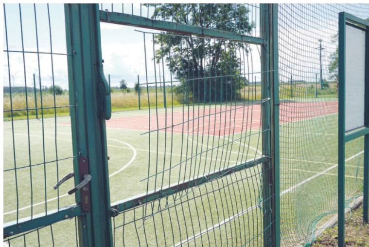
Ogrodzenie Orlika wymaga pilnej naprawy.
