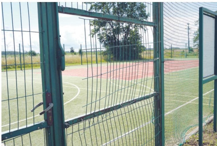
Ogrodzenie Orlika wymaga pilnej naprawy.
