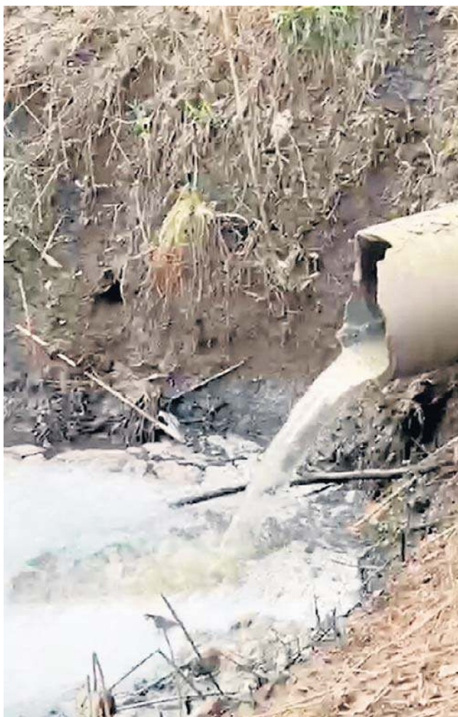
Wodociągi ustaliły, że „przyczyną zdarzenia była awaria na zaślepionym wylocie dawnego, poniemieckiego przelewu burzowego kanalizacji ogólnospławnej, który był przebudowany w latach 70. XX wieku”.
