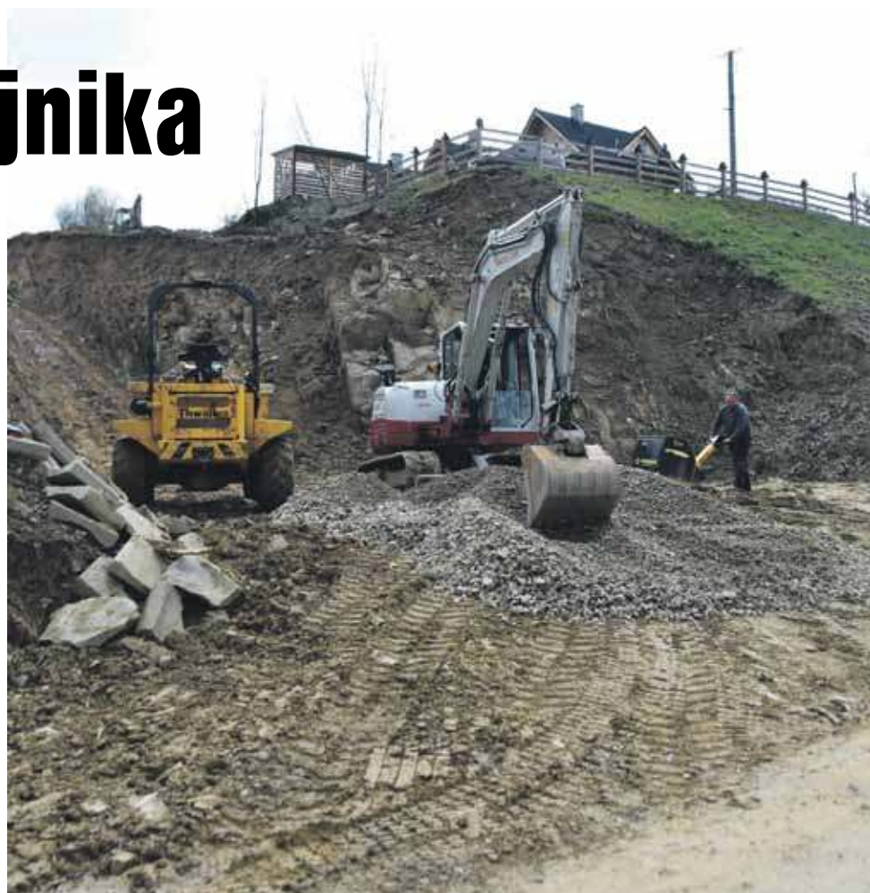
Droga dojazdowa została wyryta w skarpie, w innym miejscu niż zakładał plan.
