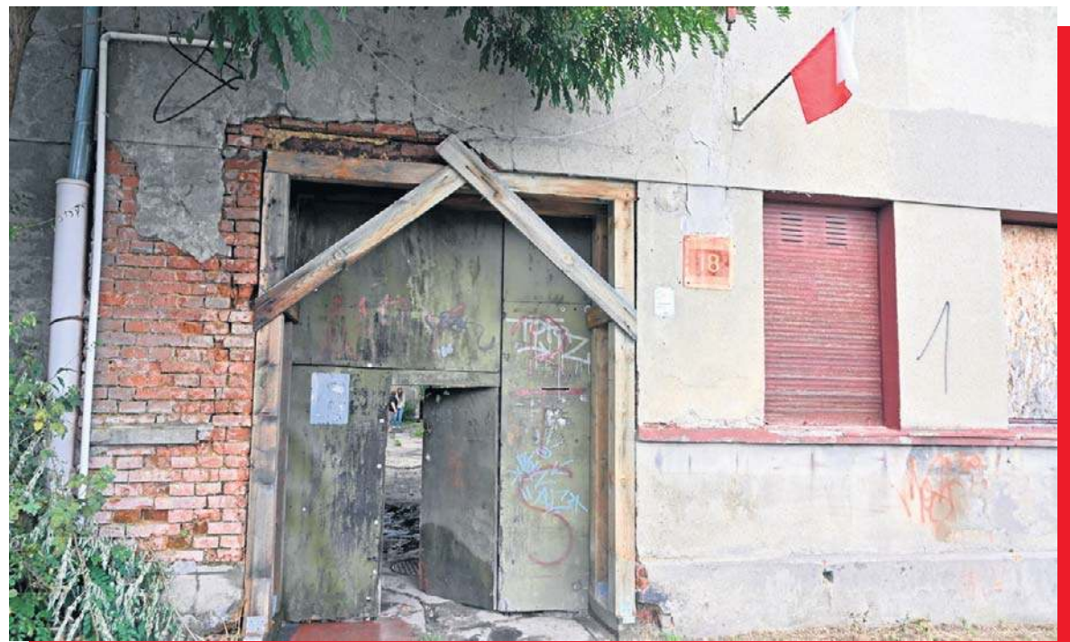
Tak wygląda wejście do budynku przy Siedleckiej 18. Pustostanem „opiekuje się” Zarząd Lokali Miejskich.
