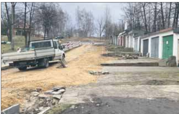
Projektanci nie uwzględnili w planie przebudowy... wjazdu do garaży
