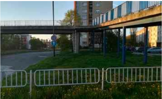
Na rozbiórkę kładki nie ma pieniędzy, a jak twierdzi nasz Czytelnik konstrukcja zaczyna się sypać i stwarzać niebezpieczeństwo dla przejeżdżających pod nią kierowców
