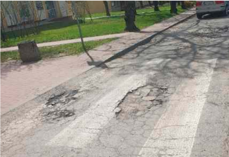
Dziury na jeździe mają zniknąć jeszcze w tym roku wraz z przebudową całego parkingu i poszerzeniem wjazdu
