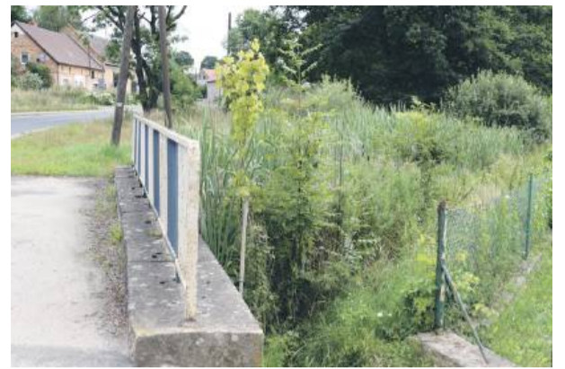
Może trudno w to uwierzyć, ale po prawej stronie barierki widzimy... Potok Nieszkowicki, a w jego korycie potężne krzewy, chwasty, a nawet drzewa
