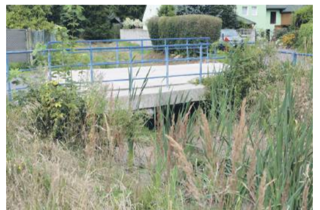
W okolicy świetlicy prześwit pod mostem jest naprawdę niewielki. Dodatkowo w korycie potoku rosną chwasty i niewielkie krzewy
