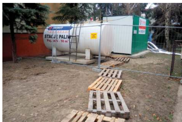
Dzięki mobilnej kotłowni większość lokatorów ma ciepło w domach
