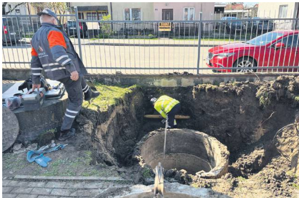
Pogotowie Gazowe szybko naprawiło uszkodzenia i zatrzymało wyciek gazu przy szkole w Werbkowicach.
