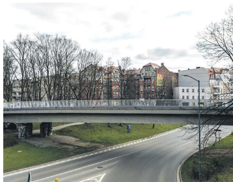
Wiadukt do remontu, więc kierowcy miejcie się na baczności
