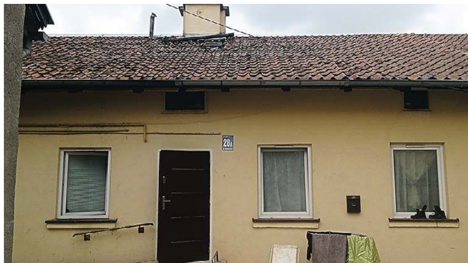
Dach przecieka w wielu miejscach
