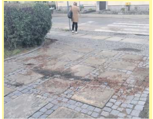
Woda stała na chodniku do wysokości widocznych śmieci
