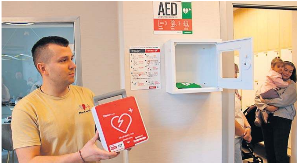
Niedawno defibrylator zainstalowano w żłobku „Akademia Malucha”. Urządzenie jest dostępne publicznie i znajduje się na mapie defibrylatorów
