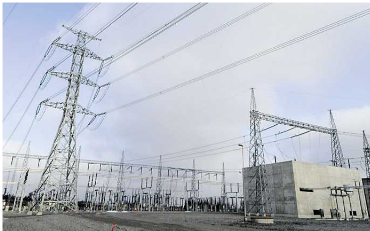
• Stacja transformatorowa EstLink 2 firmy Fingrid działająca między Finlandią a Estonią FOT. MARKKU ULANDER
