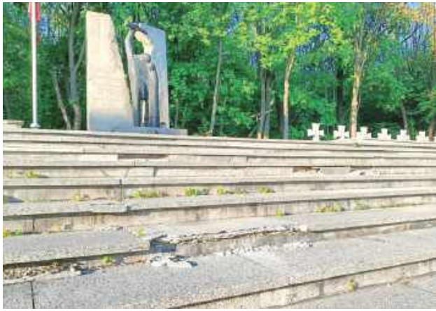
Płyty, z których zbudowane są schody prowadzące do pomnika, przy którym odbywają się zawsze uroczystości, ruszają się, co stwarza niebezpieczeństwo dla osób poruszających się tamtędy
