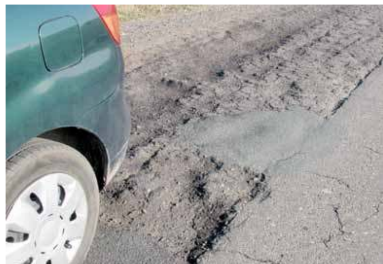
Droga powiatowa Chwarstnica-Sobieradz, beton się kruszy i powstają groźne dziury
