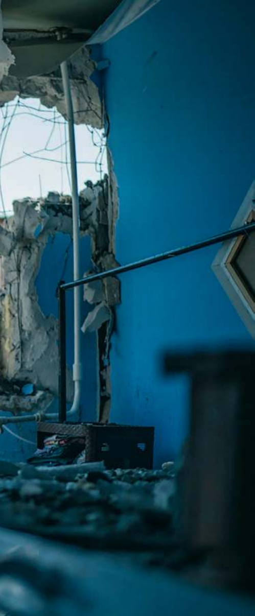
Zniszczone mieszkanie Nataliji. Charków, 26 marca 2022 r.
