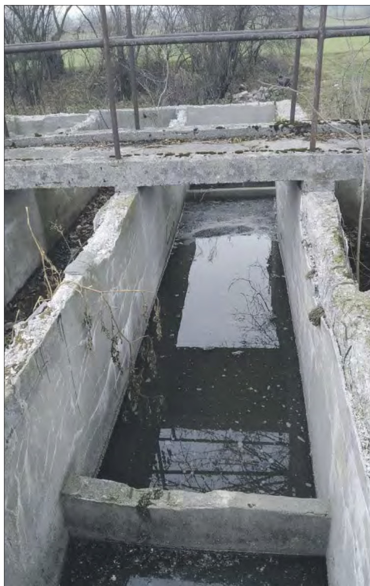
Obiekt obsługuje część mieszkańców Łącznika
