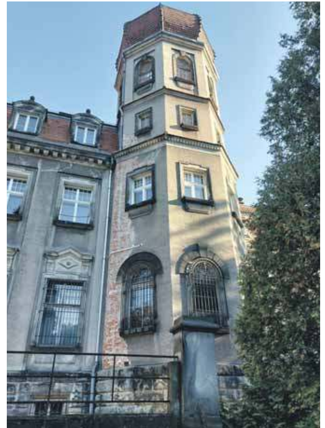
Pałac wymaga remontu
