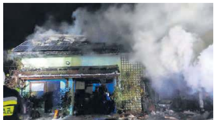
Zniszczeniu uległo poddasze i dach budynku gospodarczego wraz z instalacją fotowoltaiczną.
