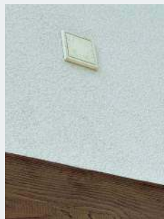
❷ Przewód wyrzutni powietrza wyprowadzono przez mur budynku.
