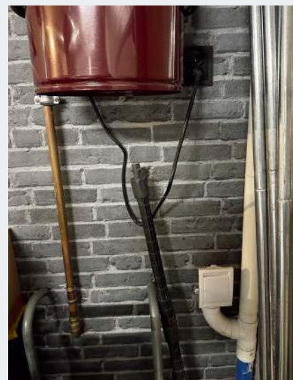
● Elementy instalacji przy jednostce centralnej.
