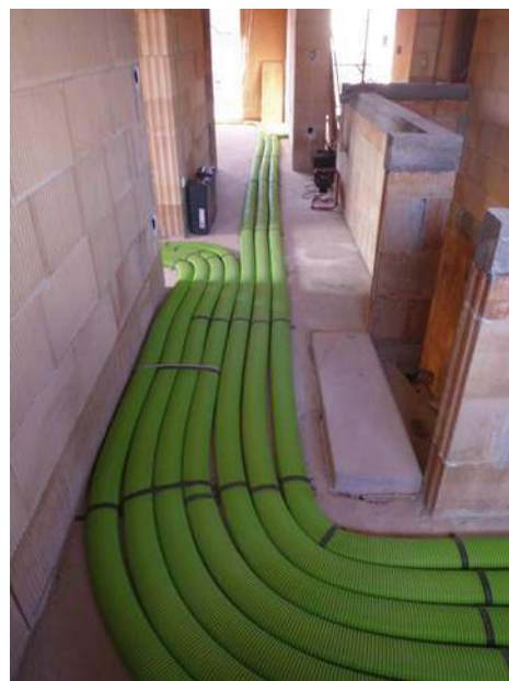
❸ Rodzaj wentylacji najlepiej jest zaplanować już na etapie tworzenia projektu domu. Wówczas bez trudu można ukryć kanały. wolf
