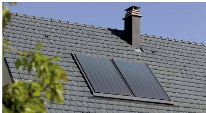
☛ Instalacja solarna z płaskimi kolektorami najwydajniejsza jest w okresie od początku kwietnia do końca września. DE DIETRICH
