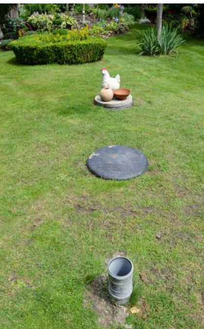
🔗 Oczyszczalnia drenażowa. W kolejności – rura rewizyjna, właz osadnika gnilnego, właz studzienki rozdzielczej, poletko filtracyjne. L. JAMPOLSKA
