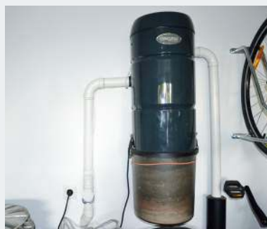
Jednostka z cyklonową filtracją wisi w pomieszczeniu technicznym.
