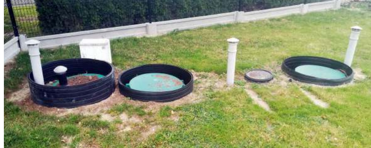
Oczyszczalnia biologiczna z osadem czynnym zajmuje mało miejsca na posesji. L. JAMPOLSKA
