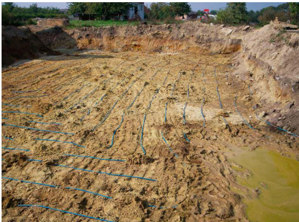
🔧 Wykonanie kolektora poziomego jest dość łatwe, lecz potrzeba na niego sporej powierzchni. DE DIETRICH (SOFATH)
