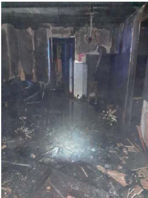
Spaliło się wyposażenie pomieszczenia na parterze
