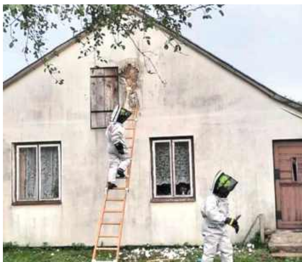
W Gołąbkach szerszenie upodobały sobie elewację domu mieszkalnego
