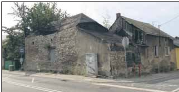
Ogród przy budynku zamieniony został w śmietnik
