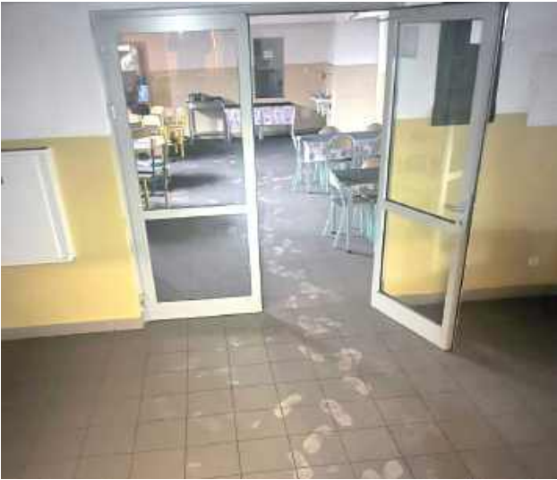
Tak wyglądają wnętrza szkoły po pożarze instalacji elektrycznej. Przy sprzątaniu pracują nauczyciele, uczniowie starszych klas, rodzice
