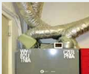
Centrala znajduje się w garażu, w łatwo dostępnym miejscu.
