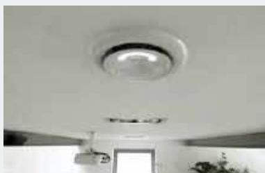
❷ Anemostat na przewodzie nawiewnym.
