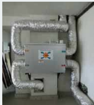
Centrala wentylacyjna w garażu i rura wyrzutni skierowana do przewodu wentylacyjnego w kominie.
