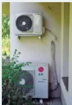
❶ Jednostki split i multi-split umieszczono w zacienionym miejscu.
