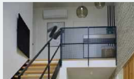
📍 Mocna jednostka wewnętrzna wisi w holu na poddaszu. Ma liczne funkcje, w tym: chłodzenie, jonizowanie, osuszanie, ogrzewanie powietrza.
