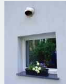
Czerpnia powietrza nad oknem w kotłowni.
