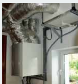
Centralę wentylacyjną zamontowano w kotłowni.
