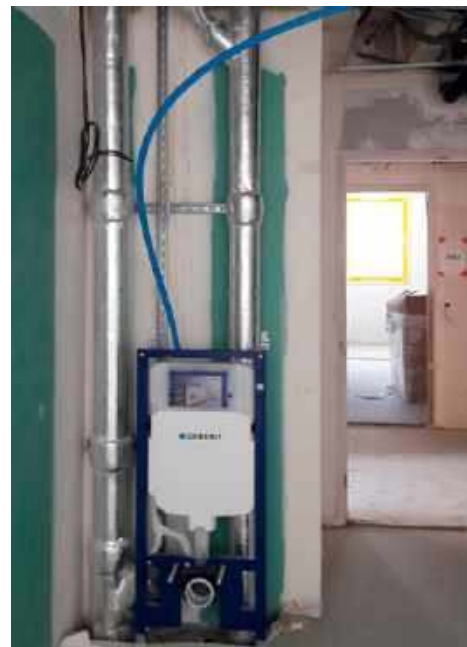
🔴 Rury kanalizacyjne obłożone izolacją akustyczną. ARMACELL
