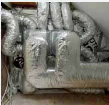
Zaizolowane przewody wentylacyjne (okrągłe i prostokątne).
