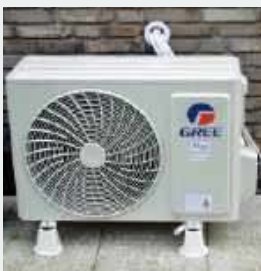
📍 Jednostka zewnętrzna i przejście instalacji przez trójwarstwowy mur.
