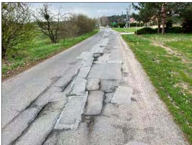
Ulica 3 Maja w Odrowążu przypomina puzzle. Mieszkańcy zastanawiają się, gdzie znajduje się pierwotna warstwa asfaltu.
