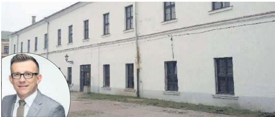
Tak wygląda Akademia Zamojska dziś. Wykonawca opuścił teren budowy. Andrzej Wnuk: Uznajemy to oświadczenie za bezskuteczne i pozorne.
