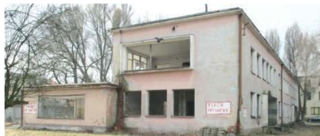
Przed kilkunastoma laty samorząd sprzedał budynek. Od tamtej pory obiekt popada w ruinę
